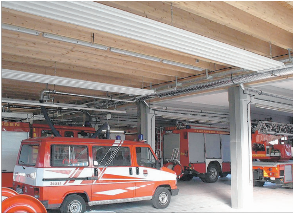
Genügend Platz für ihre Fahrzeuge hat jetzt die Süßener Feuerwehr. Die Erweiterung und Modernisierung des Feuerwehrmagazins soll bei Alarm einen reibungslosen Ablauf ermöglichen. Foto: privat
